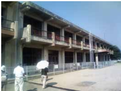
大野木場小学校被災校舎
